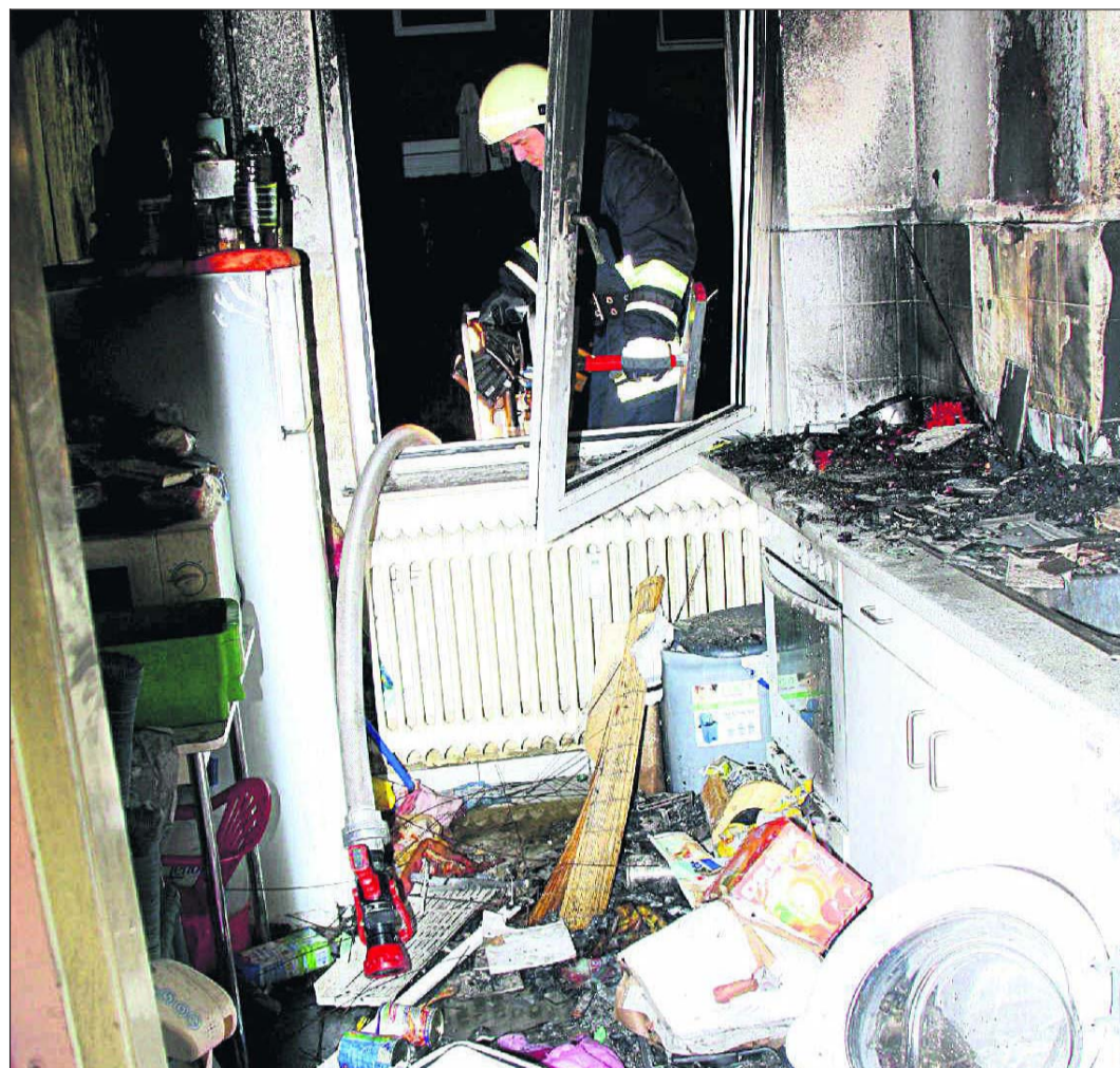
Nach dem Brand: Nach Einschätzung der Kripo entstand bei dem Feuer in einer Küche in der Christiansenstraße ein Schaden von rund 10 000 Euro. Fotos Rehbehn
