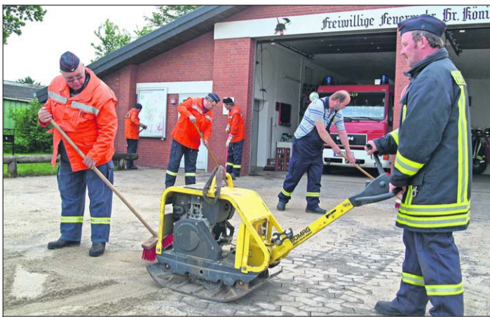
Damit die Unfallkasse nichts beanstandet: Feuerwehrmänner pflastern den Gerätehausvorplatz in Großkönigsförde. Foto Budde
