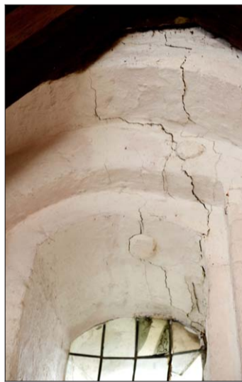
Das Mauerwerk ist auch in Mitleidenschaft gezogen.
