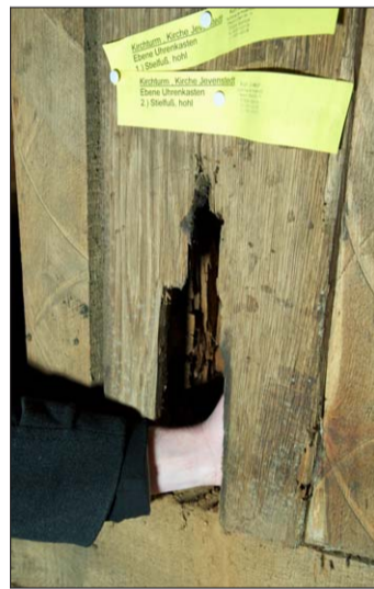
Das Gebälk ist an vielen Stellen stark beschädigt.
